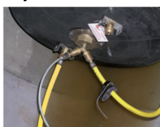
Contrôle de l'air comprimé
