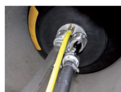
Contrôle de la pression de l'eau
